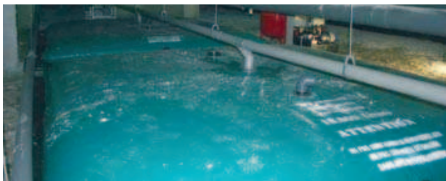
15 m³ Regenwasserrückgewinnung überdacht
