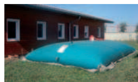
25 m³ Regenwasserrückgewinnung im Freien
