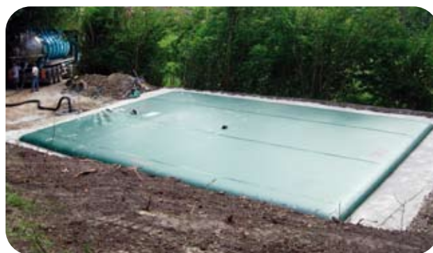
Stockage d'eau 120m 3
