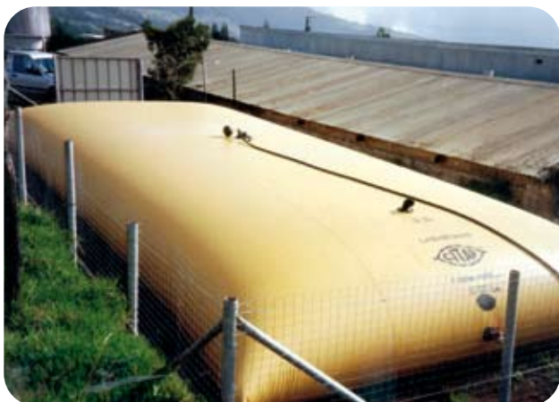
Stockage de 60m 3 de solution azotée
